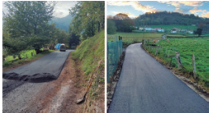
Asfaltos y construcciones del Baztan eta Viaria aglomeradok egin dituzte lanak. UDALA
